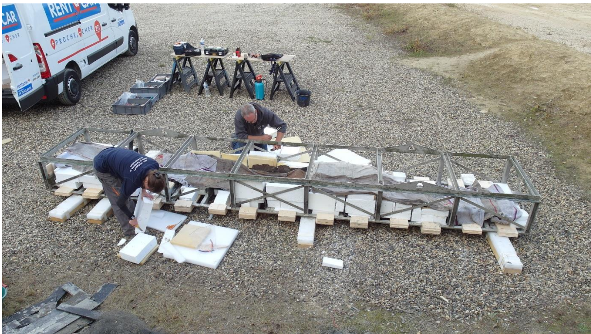
Dépose de la pirogue sur la plateforme de traitement et conditionnement avant transport (Photo : Arc Nucléart, 2022)
